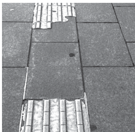
図4 点字ブロックがはがれてしまっている例
